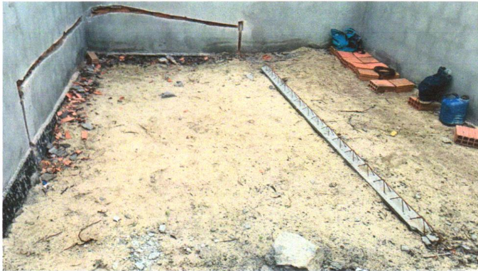
FOTO 11 – ATERRO MANUAL DE VALAS COM AREIA PARA ATERRO E COMPACTAÇÃO MECANIZADA. AF_05/2016
